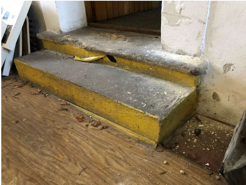
Fot. nr 4 Zabytkowa kamieniarka we wnętrzu „Domu Ariańskiego” w Pińczowie. Widok schodów pod portalem w sieni. Stan zachowania w lipcu 2020 roku.
