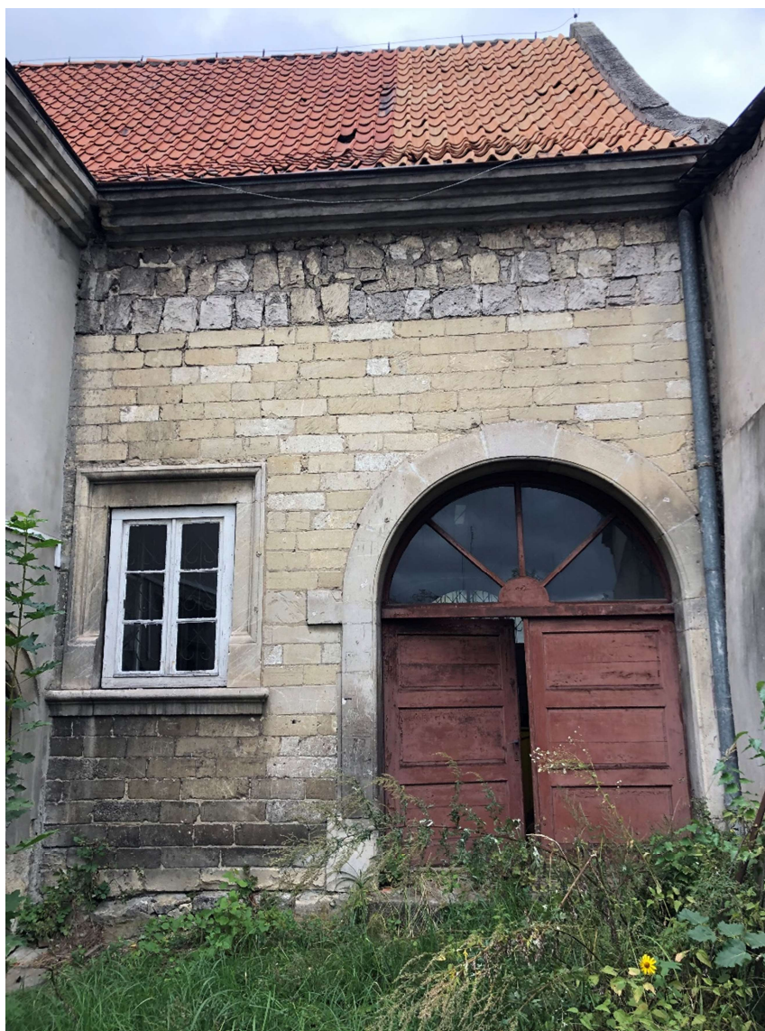
Fot. nr 1 Elewacja południowa „Domu Ariańskiego w Pińczowie” z przełomu XVI/XVII w. Stan zachowania w lipcu 2020 roku.
